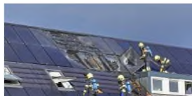
Zonnepanelen in brand aan het brandweerhaarleemst.nl
